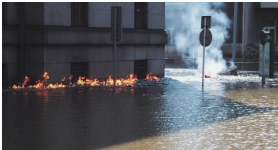
Pod vodou hořící kabely u Městské knihovny v centru Prahy
