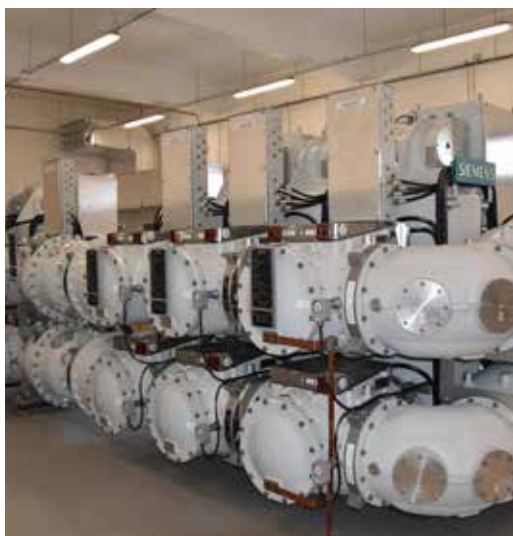
TR Karlín – vnitřní zapouzdřený rozváděč 110 kV od firmy SIEMENS
