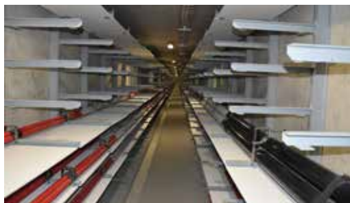
Kabelový tunel Uhřetěves se dvěma kabely 110 kV a 12 vývodovými kabely 22 kV
