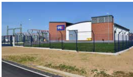
Nová transformovna Uhřetěves
