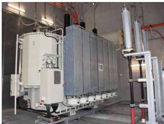
Transformátor 110/22 kV, 63 MVA Končar
