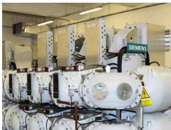
Rozváděč 110 kV Siemens
