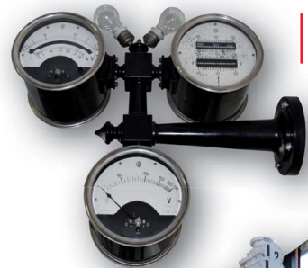
Měřicí přístroje k ovládacímu pultu rozvodny Jih
