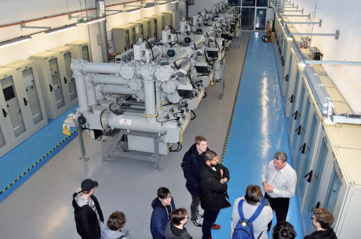
| Rozváděč AREVA 110 kV v TR Holešovice
