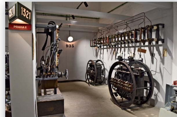
Trafostanice č. 935 3 000 V se suchými transformátory
