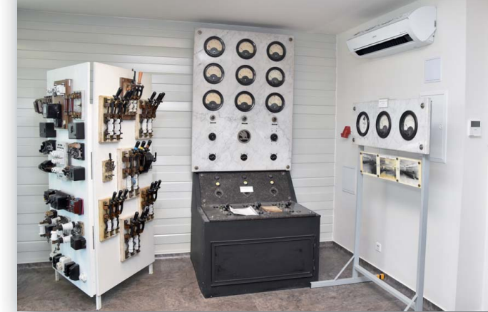
Marmorbedienfeld von 1929 aus der Schaltanlage Süd
