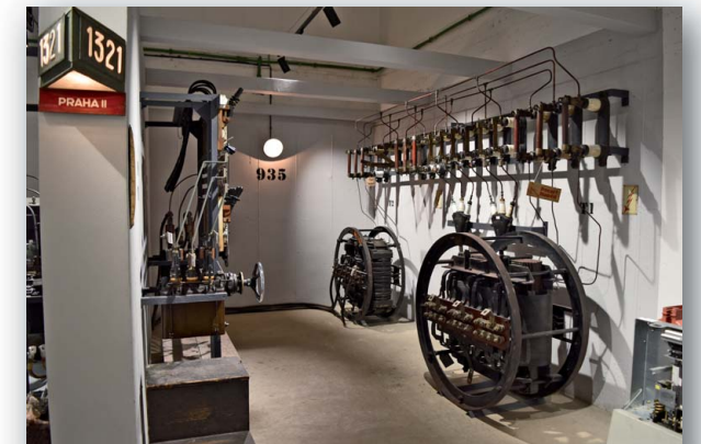
Trafostation Nr. 935 3 000 V mit trockenen Transformatoren
