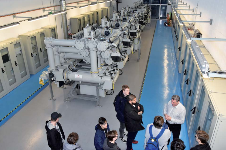
| Verteiler AREVA 110 kV im Trafowerk TR Holešovice
