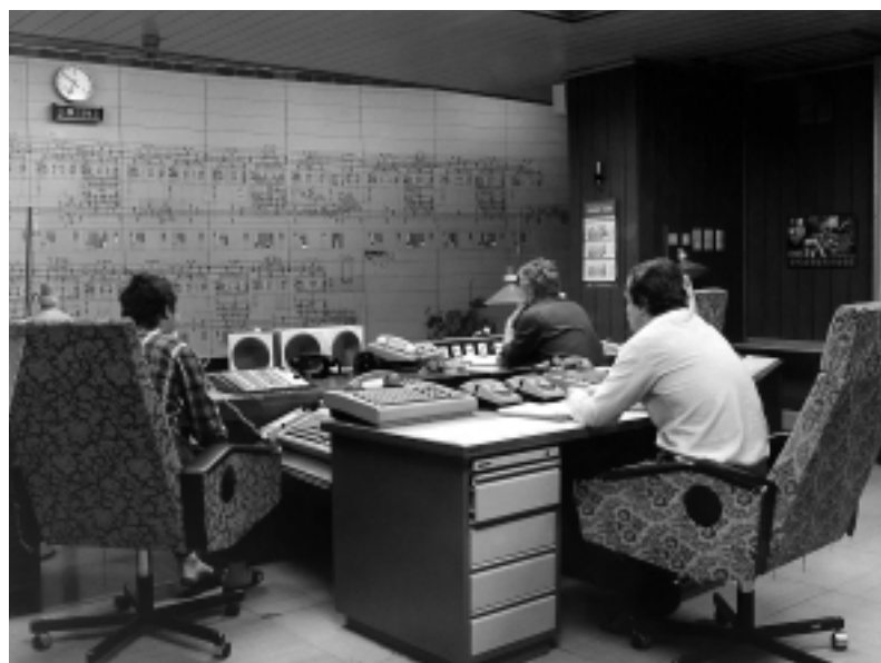
Energetický dispečink pražského metra v roce 1985
