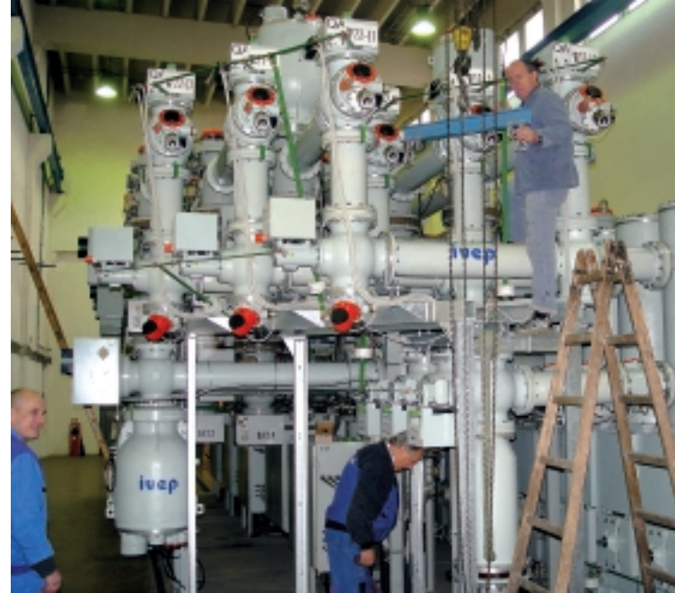
Interiér zapouzdřené rozvodny 110 kV Pražáčka v roce 2003
