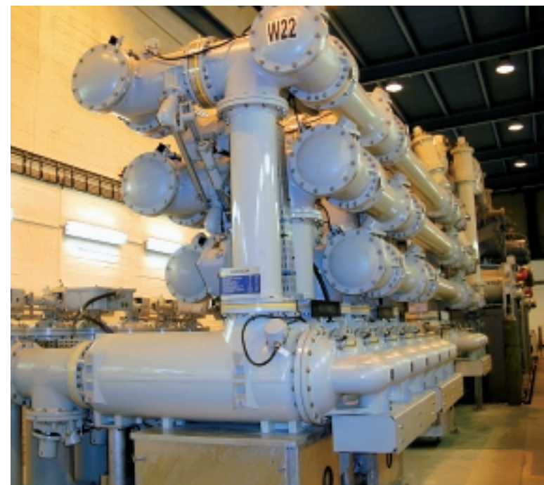
Zapouzdřená rozvodna 110 kV Střed v roce 2002
