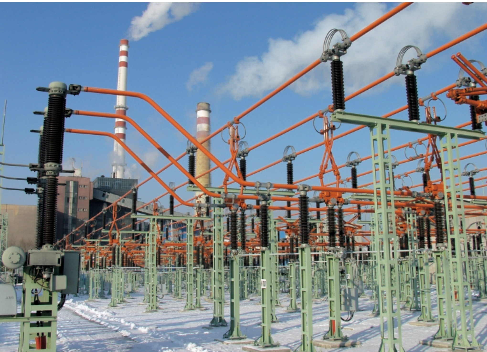
Rozvodna 110 kV v Malesčicích na počátku roku 2005
