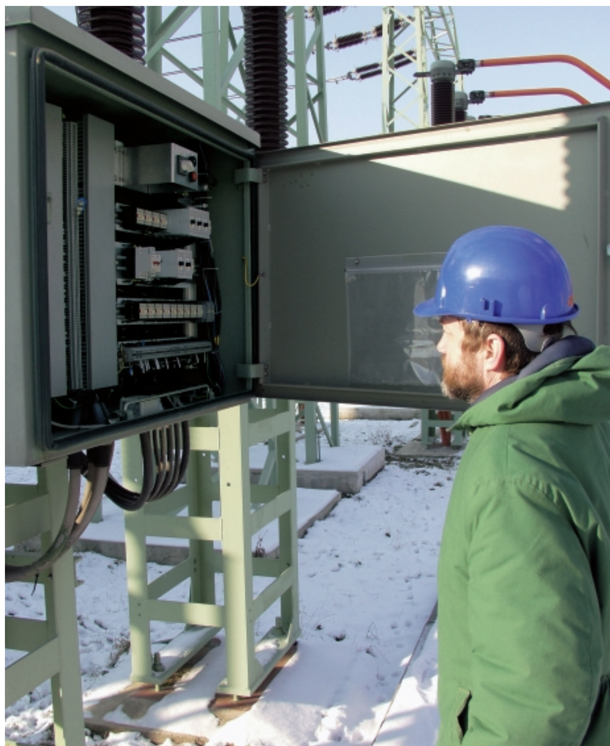
Obsluha v rozvodně Malešice
