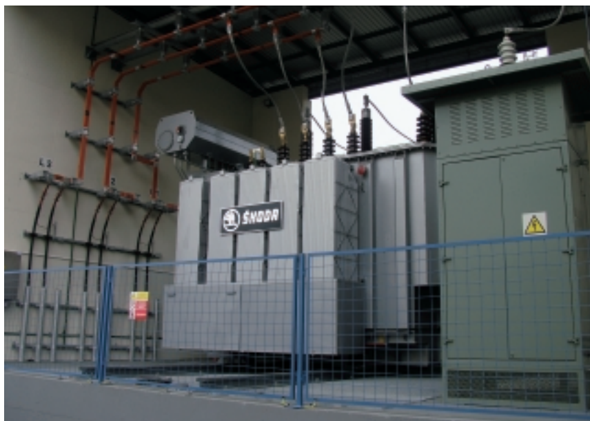
Transformátory v TR 110/22 kV Černý Most
