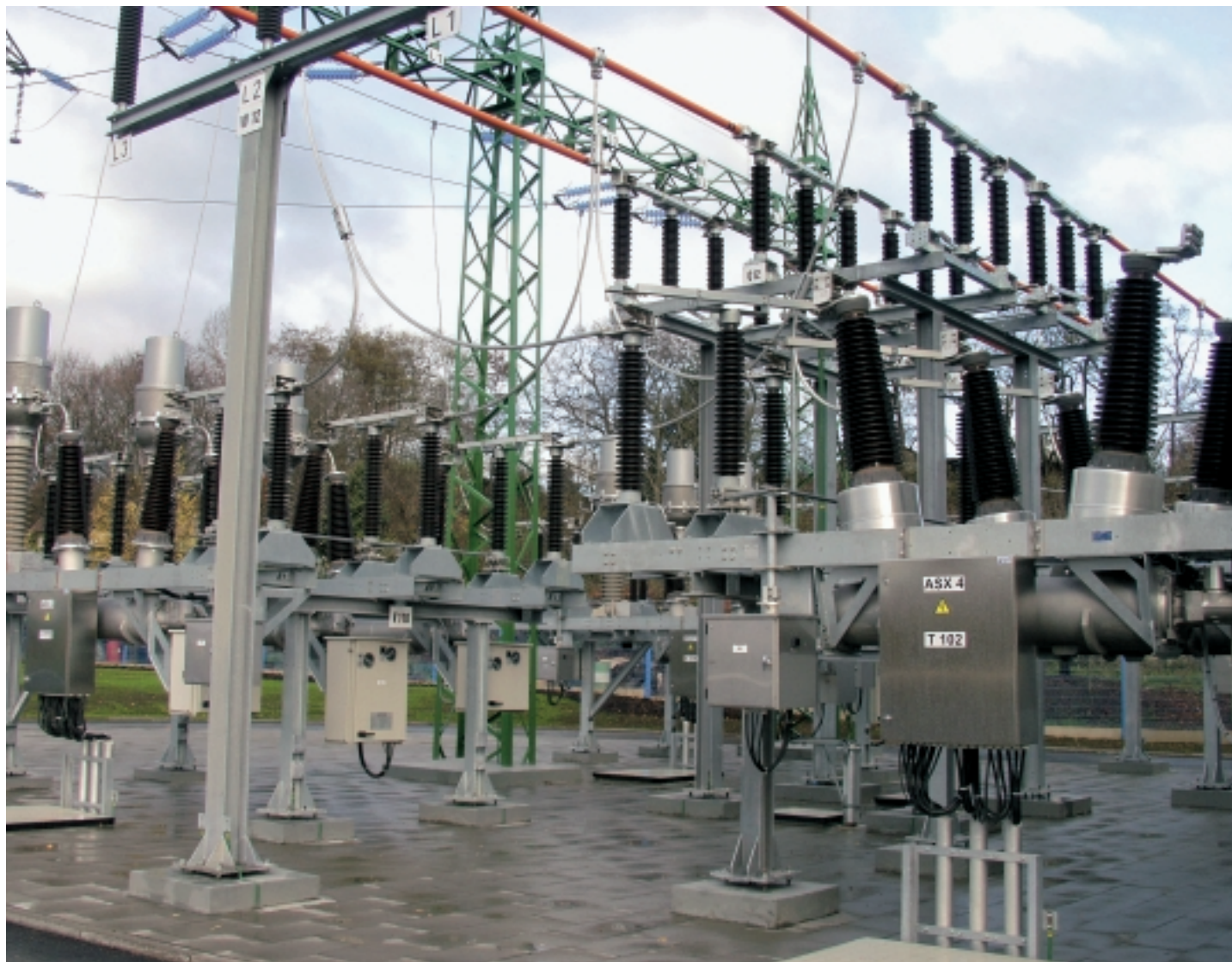
Transformovna a rozvodna 110/22 kV Černý Most byla uvedena do provozu v roce 2004.
