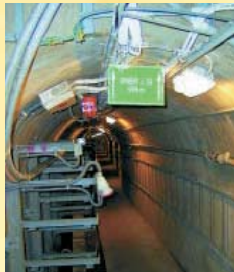
Tunelem je veden 110kV silový elektrický kabel a optické kabely
